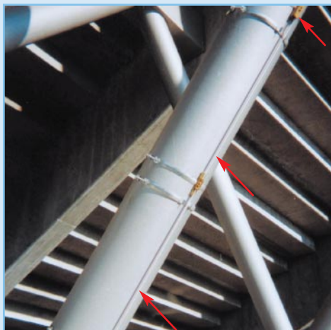
Corde optique sur construction métallique.
