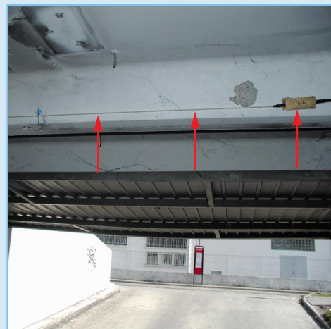
Corde optique sur poutres en béton.
