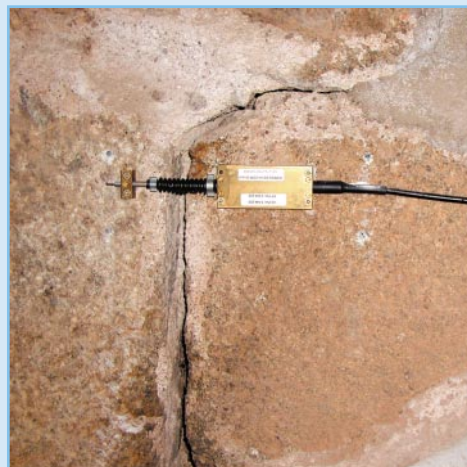
Extensomètre sur une fissure.
